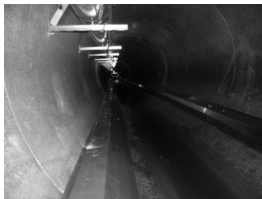
Abbildung 1. Kanalwärmetauscheranlage mit einer Heizleistung von 750 kW bzw. einer Kühlleistung von 1500 kW. © Kasag Swiss AG.
